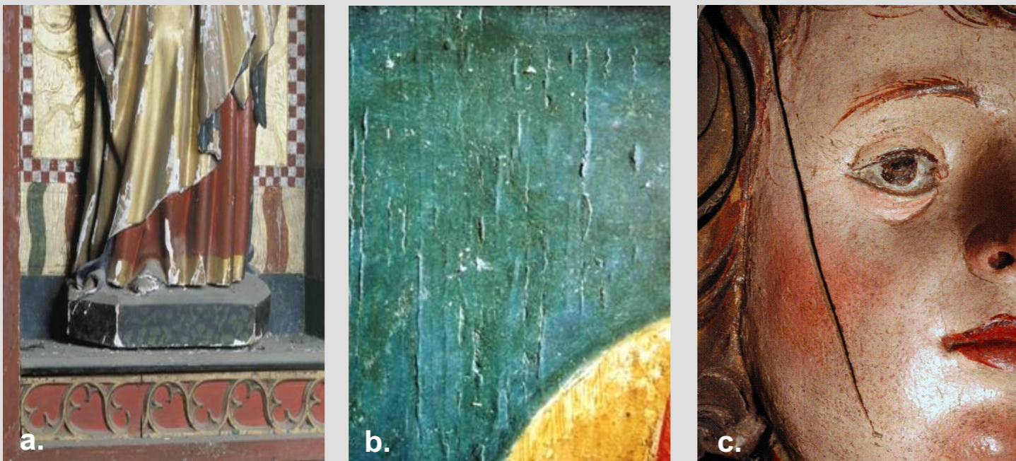
Przykłady destrukcyjnego wpływu powietrznego nadmuchowego systemu ogrzewania na stan zabytkowych dzieł sztuki w kościele:
